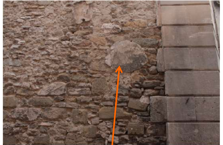
possible témoin de l'ancien enduit. A analyser (prélèvement sous génoise à faire également)
