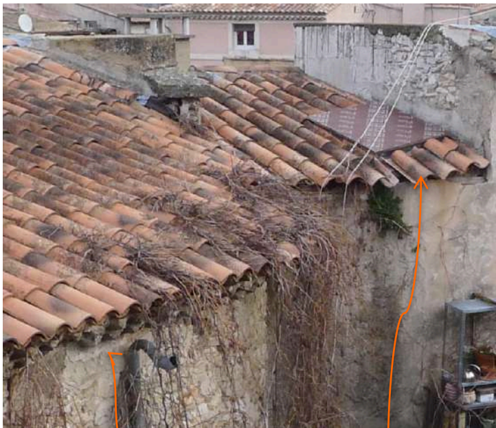
Détail du bas de pente du versant sud chapelle et bâtiment annexe avant nettoyage végétal 2015. Génoises à deux rangs dégradées, absence de système de récupération des eaux pluviales. (détail photo Direction du Patrimoine 2015)
