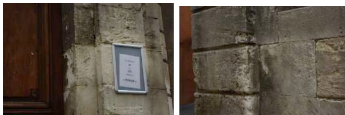
DETAIL DES DÉGRADATIONS PILASTRES PORTE
