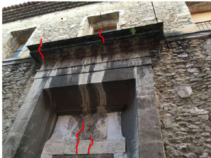
corniche d'entablement de la porte très encrasée. Salissures noires biologiques. Quelques fracture. Végétaux et lichens. Photo 2018
