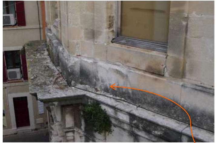
détail bandeau d'étage. Végétaux, lessivage des joints de pierre de taille. Croute noire et desquamation pierre de taille. Dégradation par éclaboussure. Photo Direction du Patrimoine 2015
