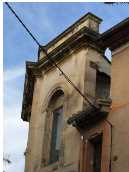
couverture de la tour d'escalier de la tribune. Entre le mitoyen et la chapelle. Cette toiture a fait l'objet de Travaux d'entretien en 2015. Photo 2018.
