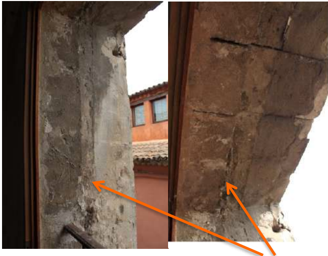
Détail embrasure et linteau fenêtre d'étage. Trace de l'ancienne feuillure. Pierre de taille dégradées, épaufrures, perte de joint.
