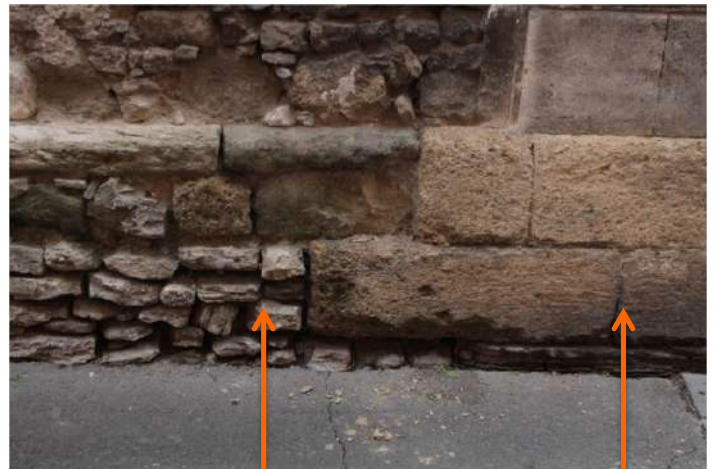
détail du soubassement à l'angle des façades Ouest et Nord. Bandeau pierre de taille et Soubassement moellons destinés à être enduit
