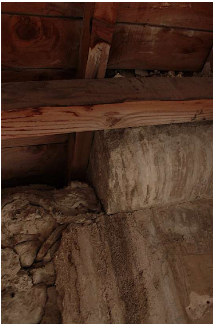
La charpente du volume d'escalier d'accès à la tribune est totalement remaniée. (Détail de la pierre sablière). L'ensemble de la toiture et des maçonneries en élévation nécessite une restauration soignée.
