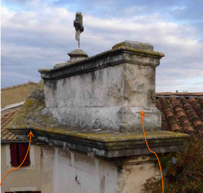
Détail du corps et corniche de l'attique. Desquamation pierre de taille. Mousses, lichens et croute noire sur le bandeau et rampant du fronton triangulaire. Photo Direction du Patrimoine 2015.
